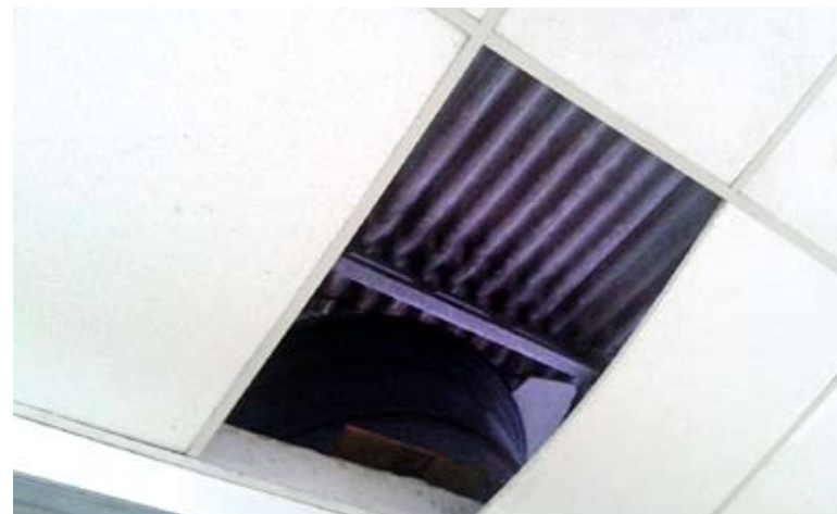
Parte do teto do 3º Ofício Cível de Praia Grande que desabou devido a problemas com a caixa de água do prédio
